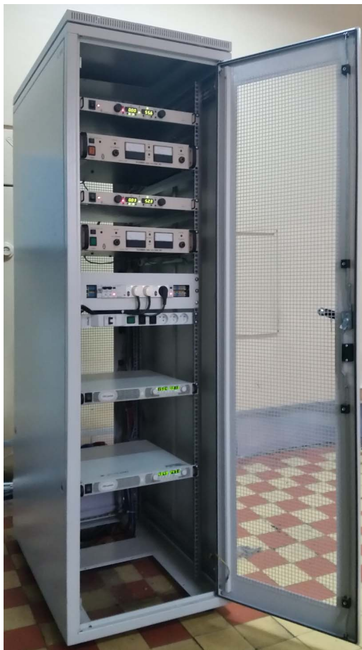
Rysunek 9. Szafa z zasilaczami Źródła Jonów i Deflektorów.
