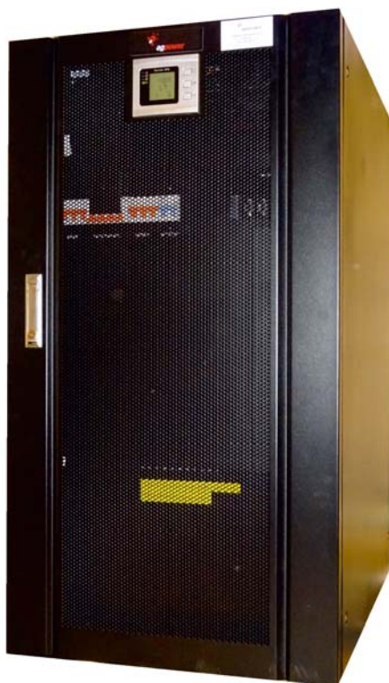
Rysunek 5. Zasilacz UPS SIRIUS SR015T firmy GTEC zainstalowany na rozdzielni głównej budynku Cyklotronu AIC-144.
