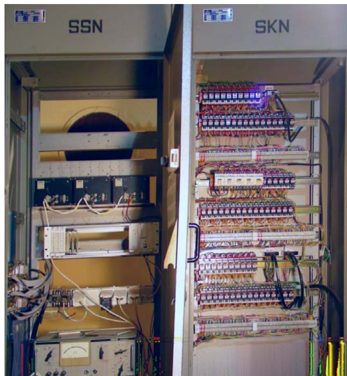
Rysunek 18. Szafy sterownicze systemu sterowania silnikami i serwomechanizmami Cyklotronu AIC-144.
