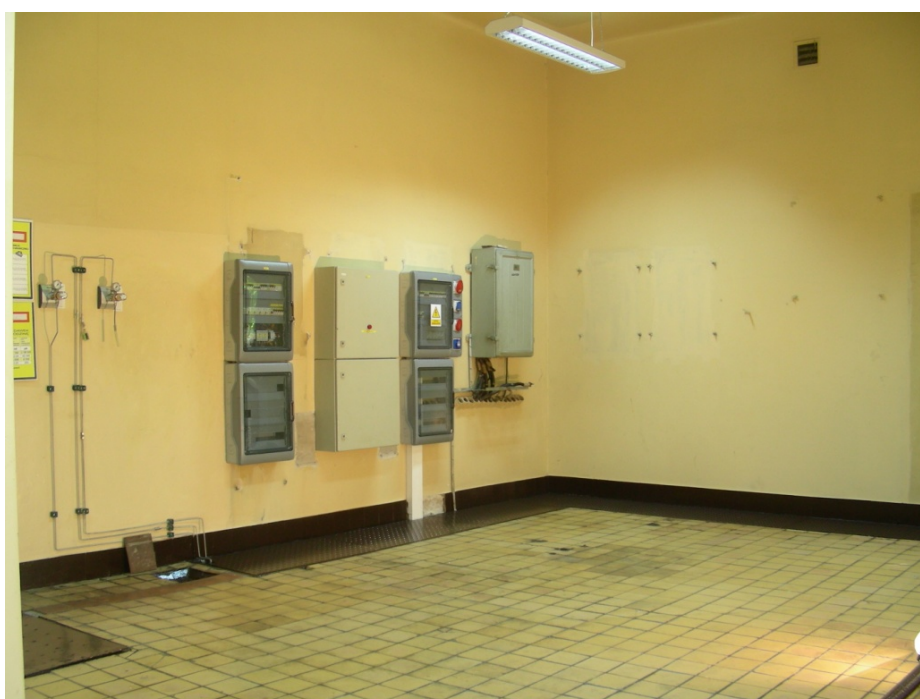
Rysunek 24. Pomieszczenie z nowymi rozdzielnicami.
