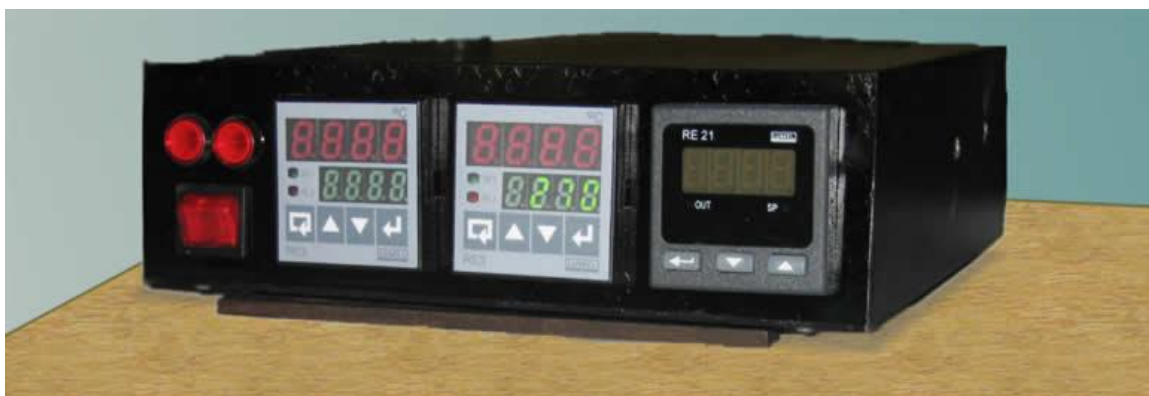
Rys. 23. Panel kontrolny sterownika temperatury
