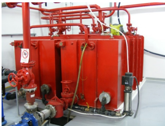
Rys. 7. Zbiornik wyrównawczy wody demineralizowanej.
