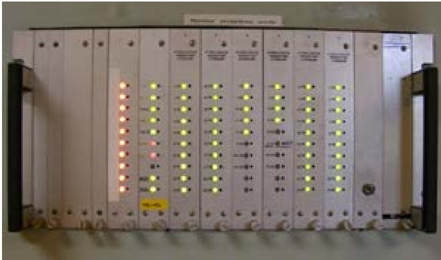
Rys. 16. Widok panelu z modułami kontroli przepływu .
