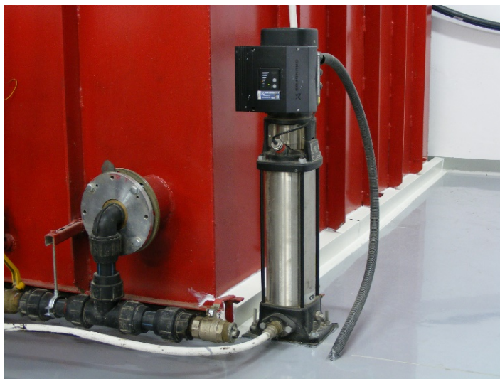
Rys. 11. Pompa obwodu chłodzącego układu wytwarzania próżni [11].
