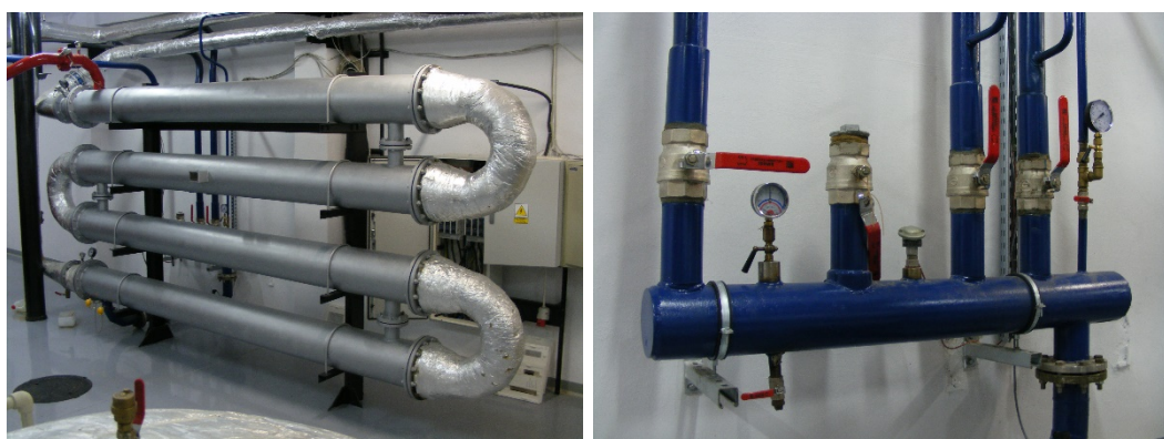
Rys. 9. Wymiennik ciepła i główny kolektor rozdzielający na jego wyjściu.
